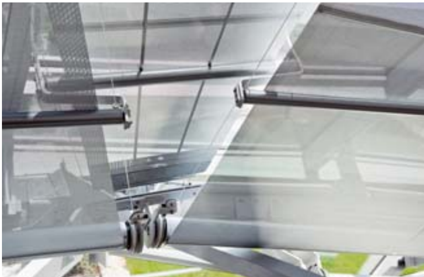
Unterstreicht die Form der Fassade, ohne sie zu dominieren: transluzenter textiler Blendschutz aus Polyester-gewebe.
